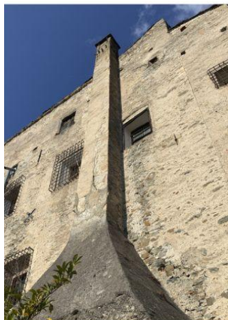
Cappa e canna fumaria da mettere in sicurezza
